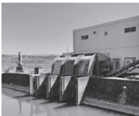
▲内水被害を軽減する大切な施設
