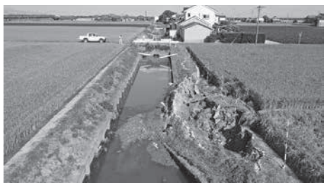
▲令和2年9月豪雨被害を受けた社にある水路
