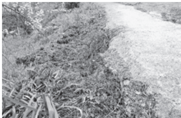
▲イノシシによる、道路のり面の被害
