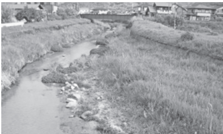
▲土砂が堆積している晴気川
