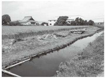
▲農業用排水路の災害状況
