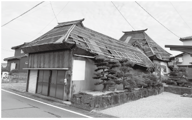
▲今年8月に代執行された特定空き家（危険空き家）
