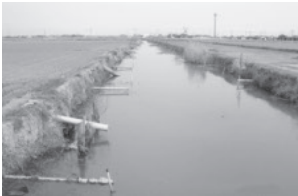
▲法面が崩落した水路
