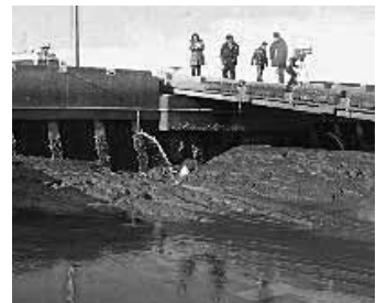
▲泥土対策の排水ポンプ
