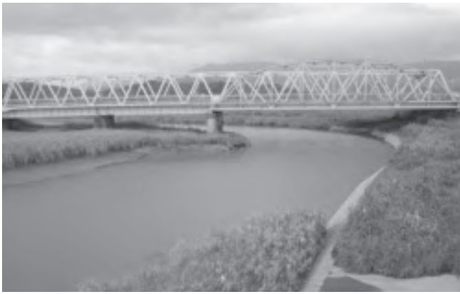
▲流れを阻害する中央部の橋脚
