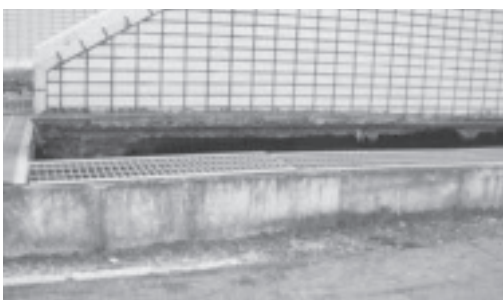
▶一部陥没している芦刈文化体育館
