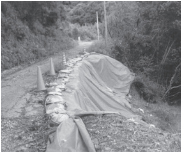
▲寺浦の災害現場
