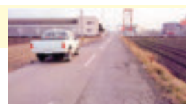
損傷した市道
