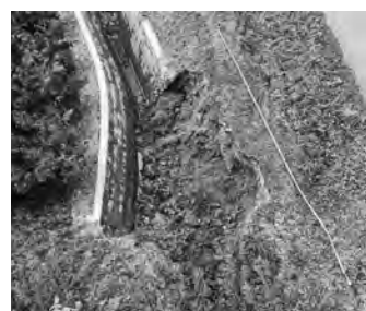
▲水路法面崩壊
