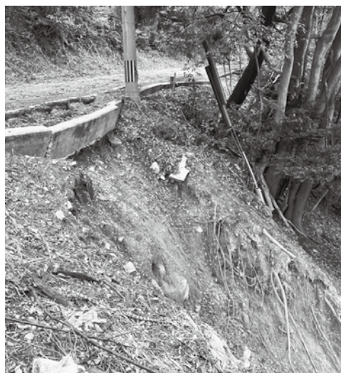
▲令和3年8月豪雨で被災した林道天山線
