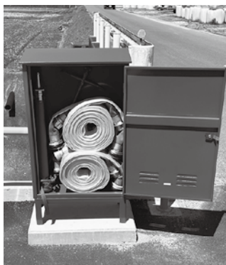
▲消火栓ホース格納箱
