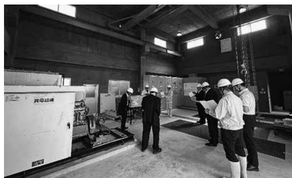
▶三日月東部排水機場（三日月町堀江）
