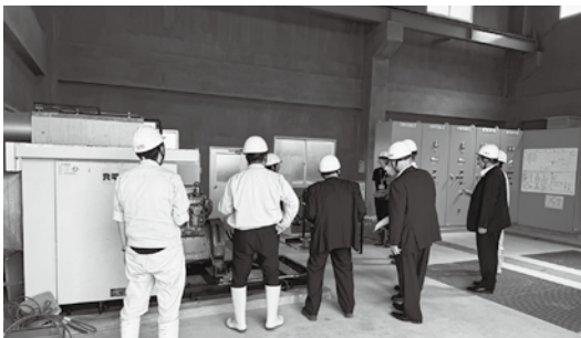
▲故障が判明した三日月東部排水機場 (現在は修理完了)
