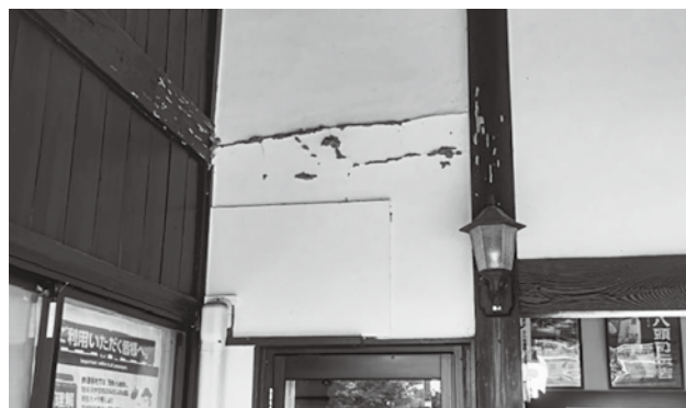
▲JR小城駅舎シロアリ被害状況
