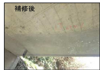
RC床版橋の鉄筋露出
