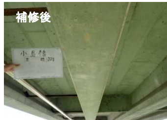
PC橋のひびわれ
