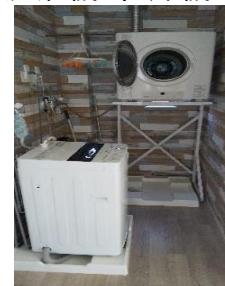
洗濯機・乾燥機
