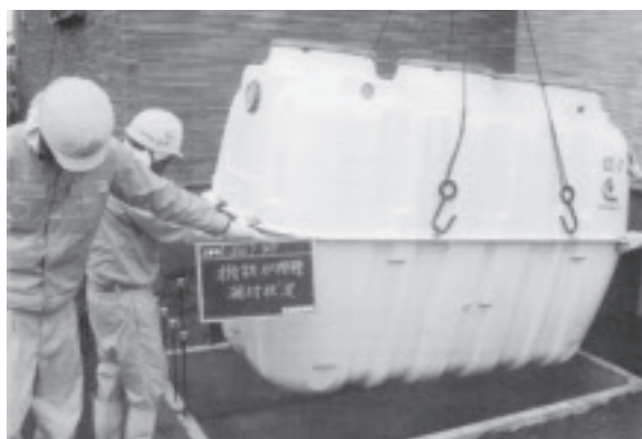
▲合併処理浄化槽を含め検討されている
