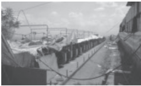
▲台風13号で倒壊した畜舎
